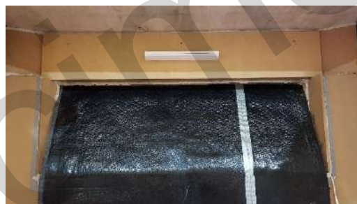
Vue du montage (côté réception).
